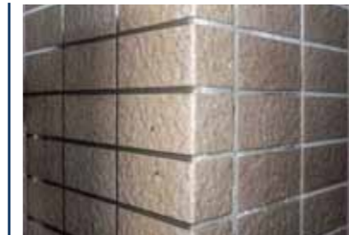
アレスアクア タイルガード 未施工面 濡れ色になっている
